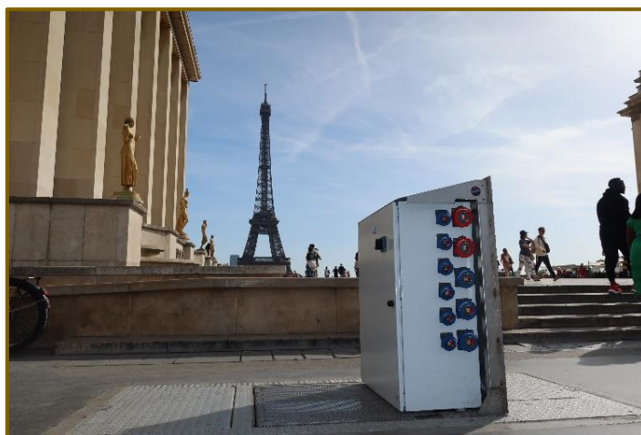
Borne électrique événementielle rétractable sur la place du Trocadéro (Source : ENEDIS)
