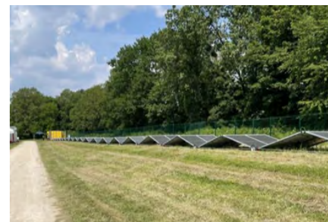
Panneaux solaires temporaires (pliants) pour alimenter OBS pour le départ d'aviron
