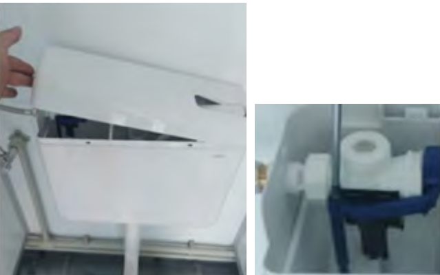
Un simple réglage des chasses d'eau a permis d'économiser 30% d'eau sur ce poste de consommation. L'ajout d'aérateur sur les robinets des modules sanitaire a également contribué à réduire drastiquement la consommation.
