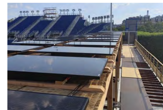
Détail panneaux solaires sur salon hospitalité Tour Eiffel
