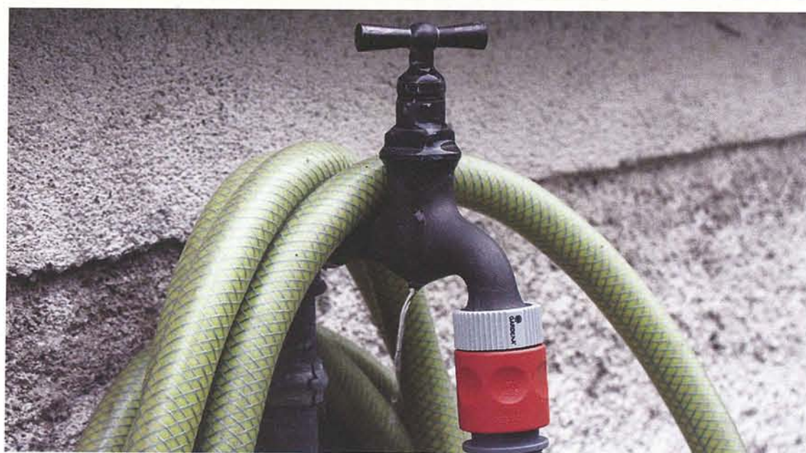
Figure 22 : Un robinet qui fuit est une source importante et souvent négligée de gaspillage de l'eau.
