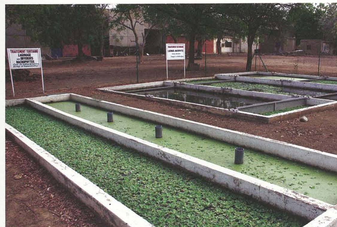
Figure 6 : Traitement des eaux usées en Afrique (Burkina Faso) par phyto-épuration.
